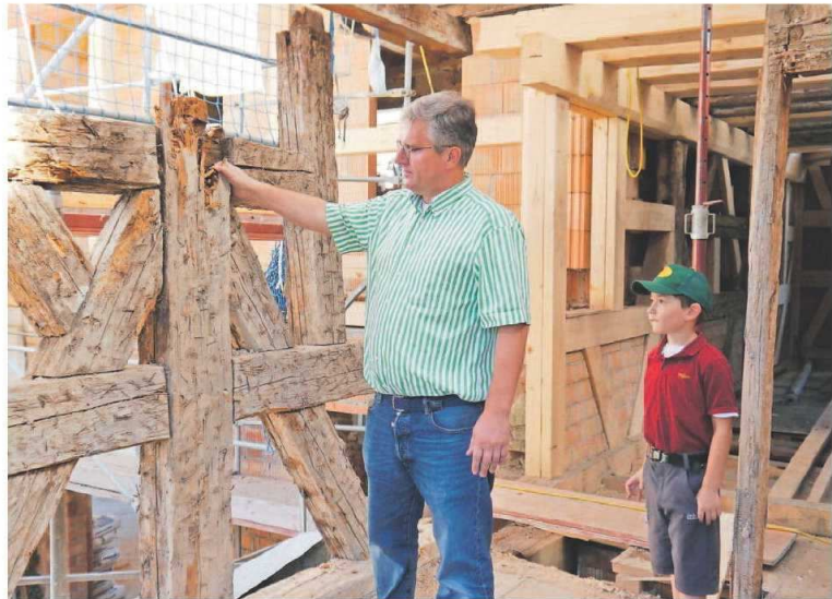
Architekt Helmut Rester und Sohn Jack besichtigen die Baustelle in Herzogenaurach und zeigen schadhafte Balken.
